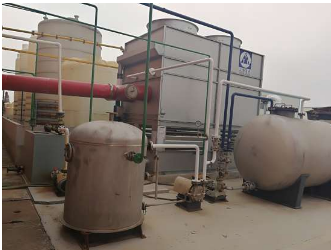
二效蒸发冷凝装置
