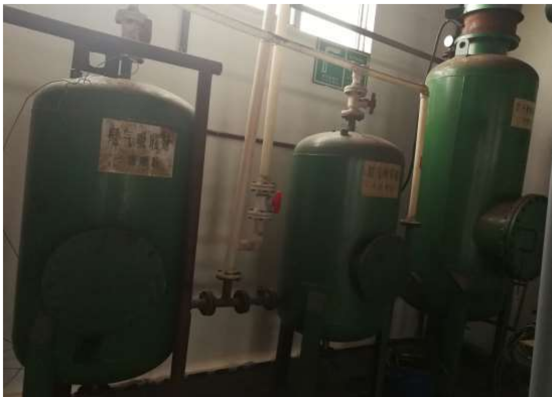
车间尾气二级吸收罐
