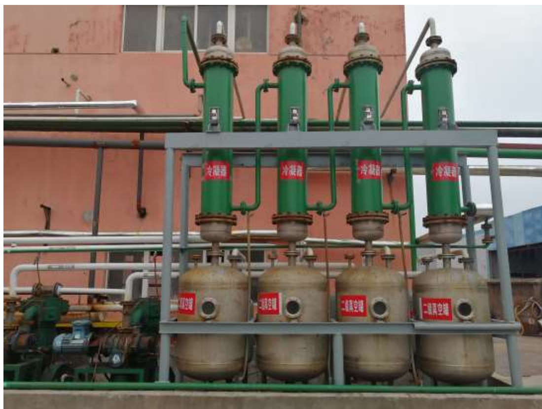
车间尾气二级冷凝吸收装置
