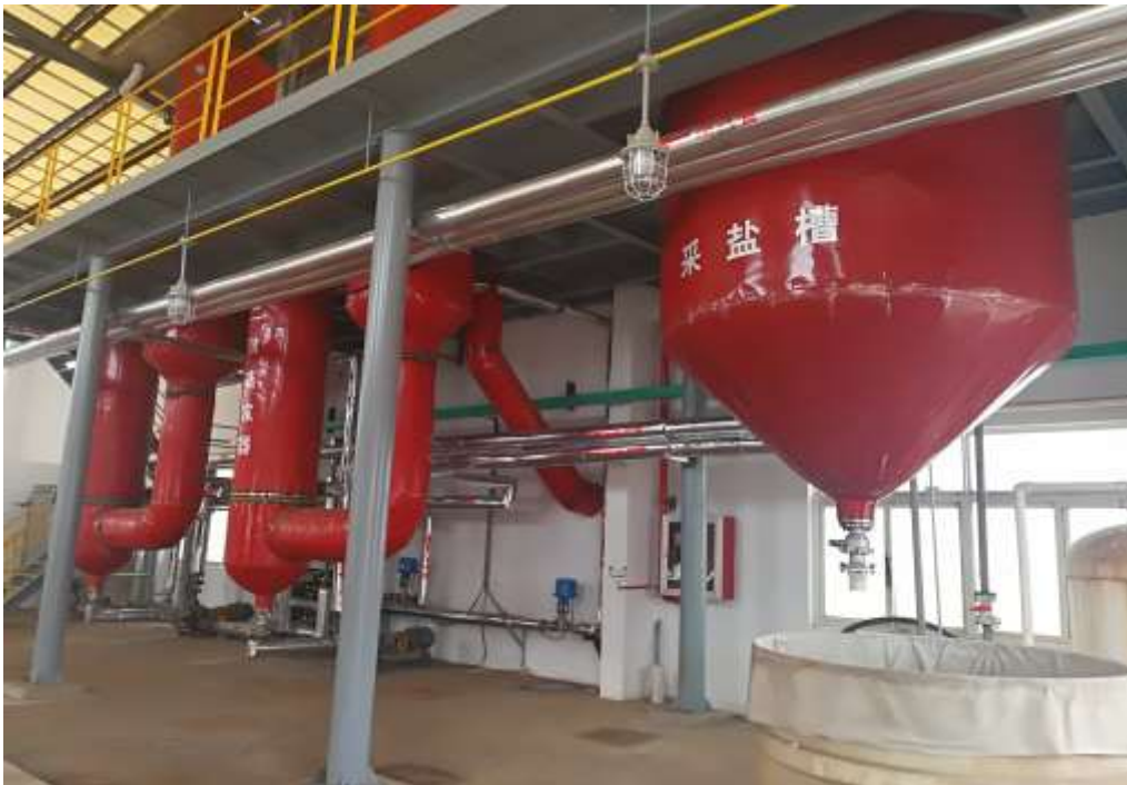
三废车间二效蒸发除盐装置
