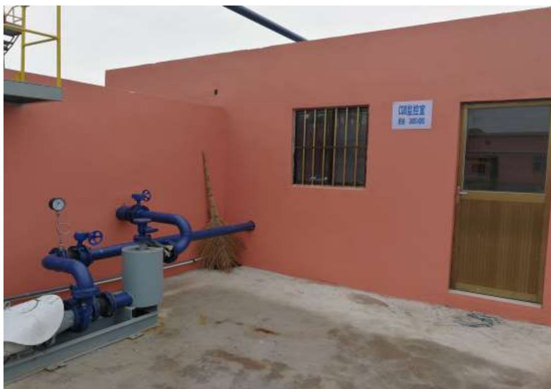
废水输送泵及 COD 监测室
