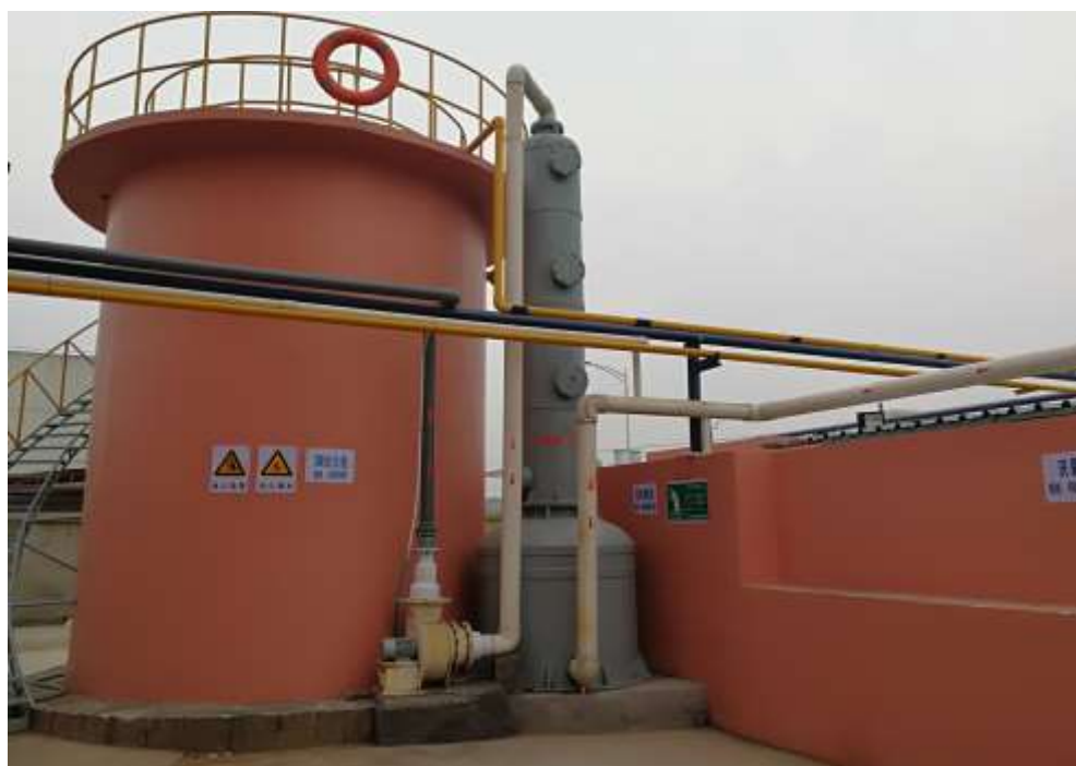
二效蒸发有机物及厌氧池尾气吸收塔
