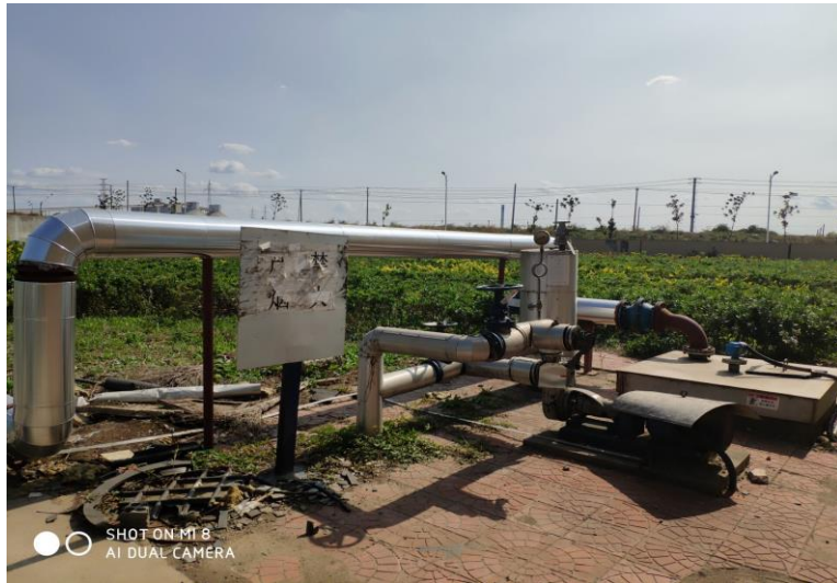
事故应急池照片
