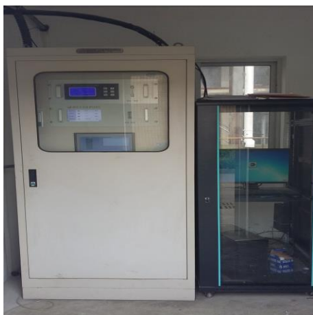
烟气排放连续监测系统
