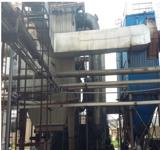
固废焚烧炉尾气布袋除尘器
