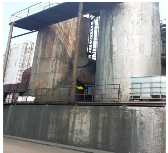
固废焚烧炉尾气碱喷淋设施
